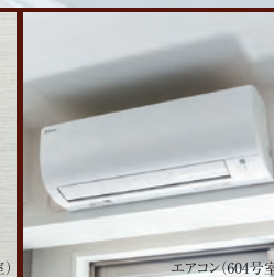
エアコン(604号室)
