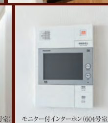
モニター付インターホン(604号室)
